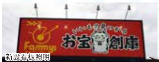
新設看板照明
